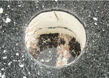
Stehendes Wasser auf Dampfsperrbahn
